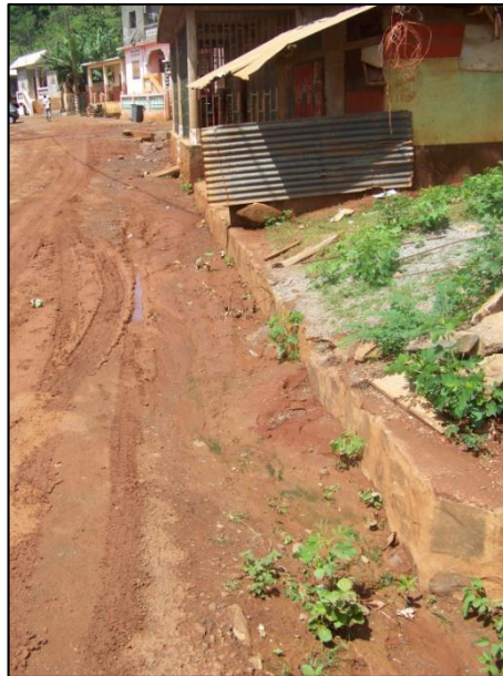
Figure 1 : Coulée boueuse à Hamjago
