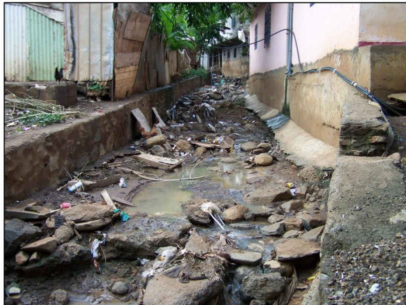
Figure 8 Insalubrité d'une ravine (Majicavo-Koropa)
