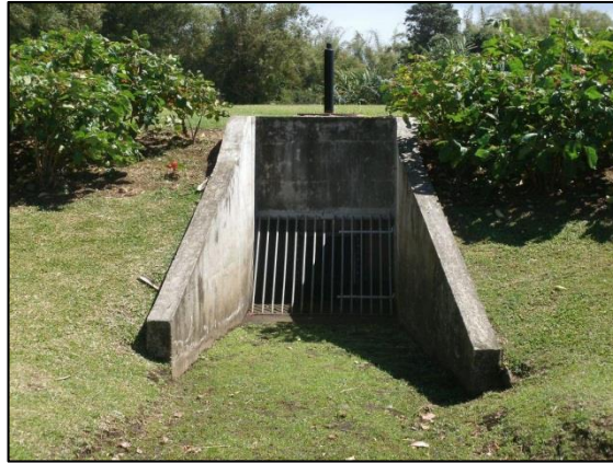
Figure 21 Dégrilleur en tête d'ouvrage
