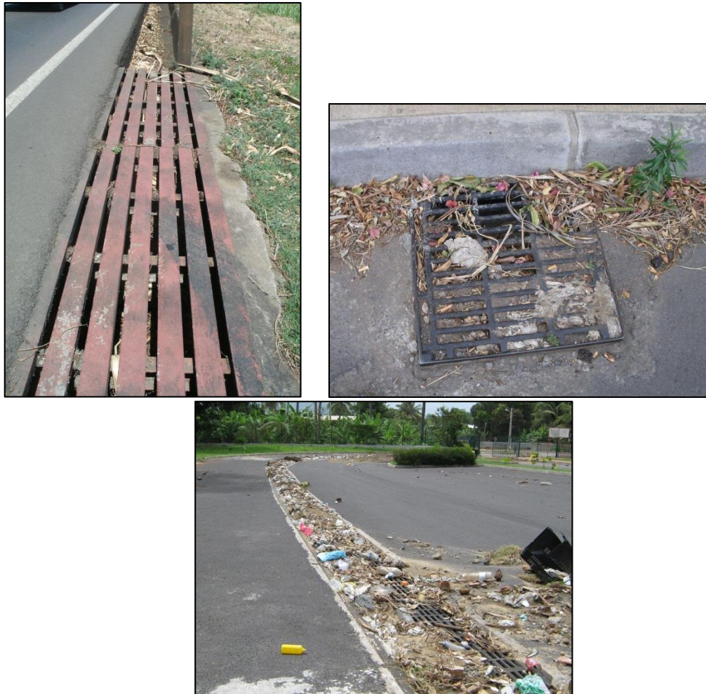
Figure 19 Grilles en couverture d'ouvrage
