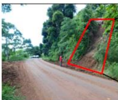
Glissement de terrain sur la route départementale 1 avant Acoua, Sources : Rapport BRGM 2021
