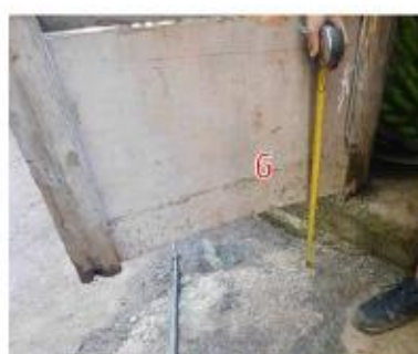
Laisse de crue à l'intérieur d'une porte d'un local. Sources : Rapport BRGM 2022
