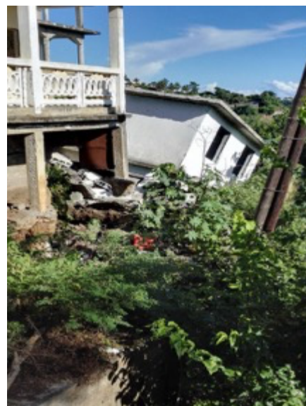
Éboulement à Koungou
