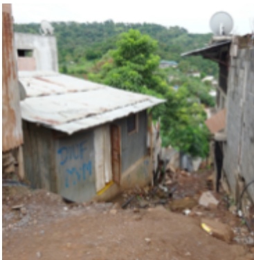
Vue des maisons présentant des risques d'effondrement, Majicavo
